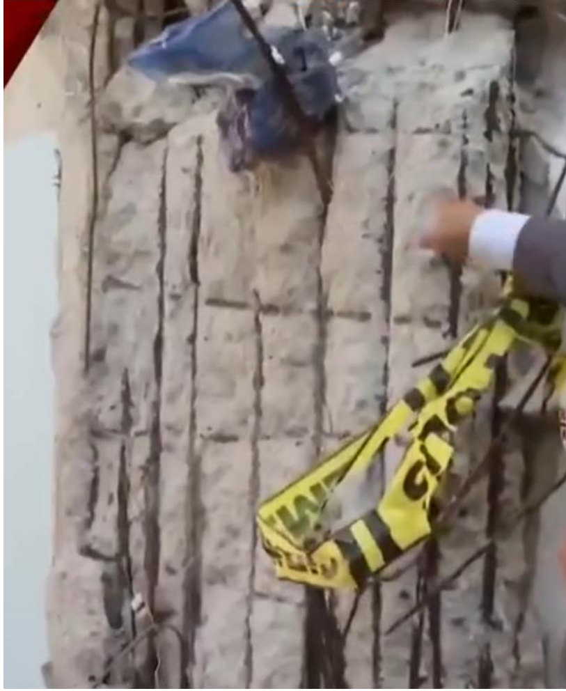
Yıkılan binanın ayakta kalan kolonlarından görüntü
